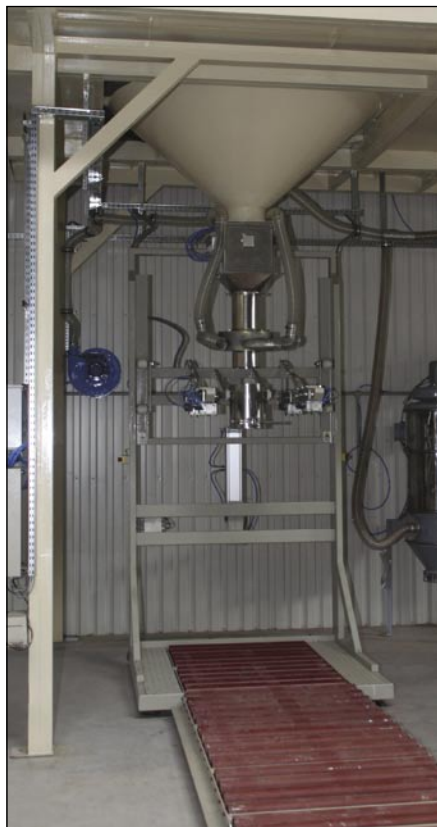
Fot. 10. Urządzenie EWN-BB z układem odbioru worków
